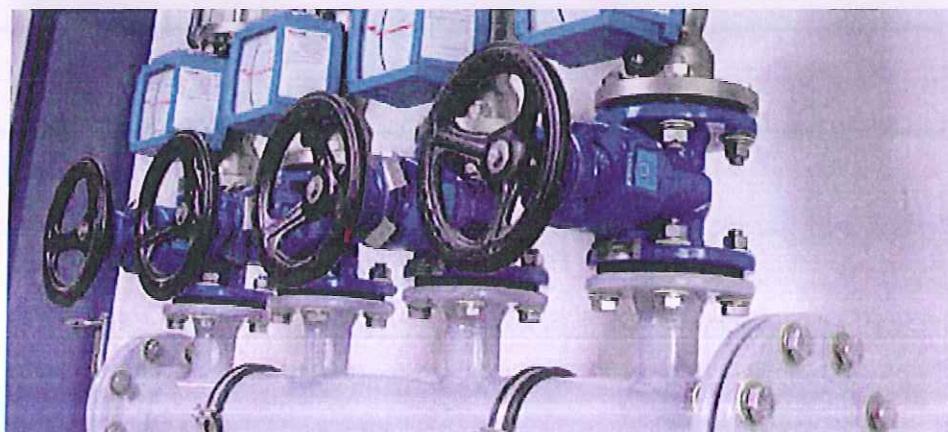
Stacja przygotowania wody do picia Luisenthal, Niemcy 35 zasuw klinowych VAG BETA® 200
